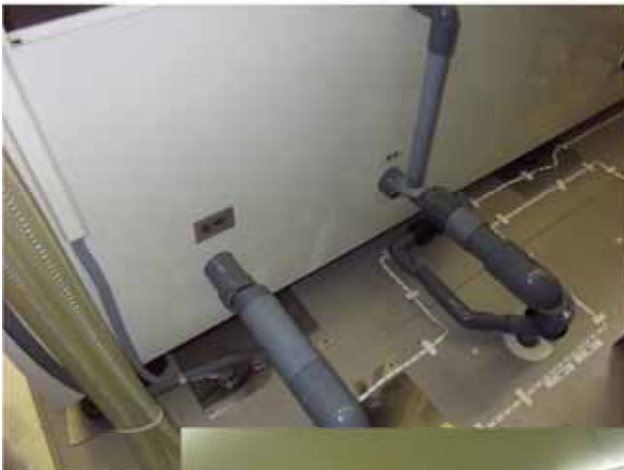
↓ドラフト裏のフッ酸排出パイプ
