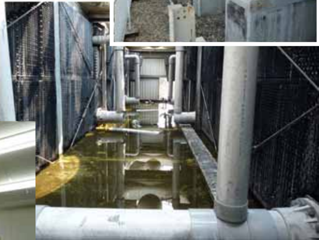
パイプが破断した冷却塔内部
