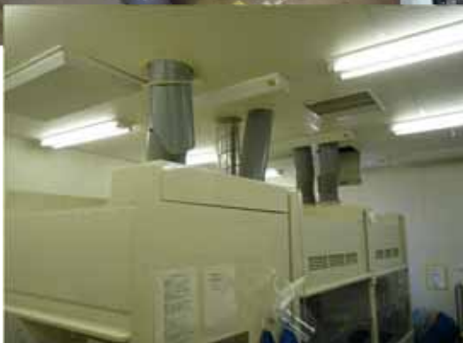
ドラフトの排気ダクト
